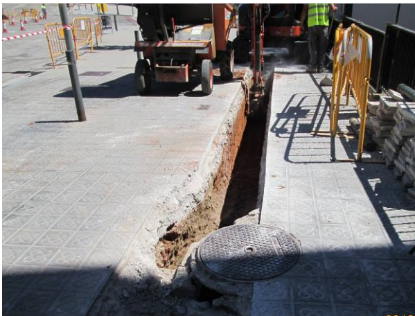
37. Tram 3: serveis actuals situats al mig del traçat de la rasa
