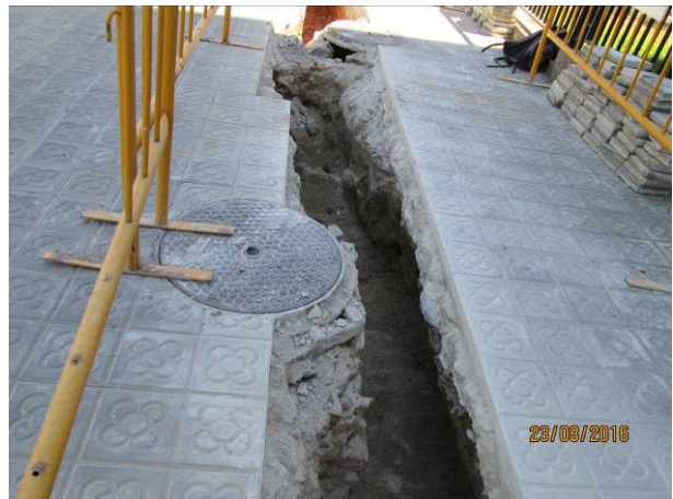
38. Tram 3: serveis actuals situats al mig del traçat de la rasa
